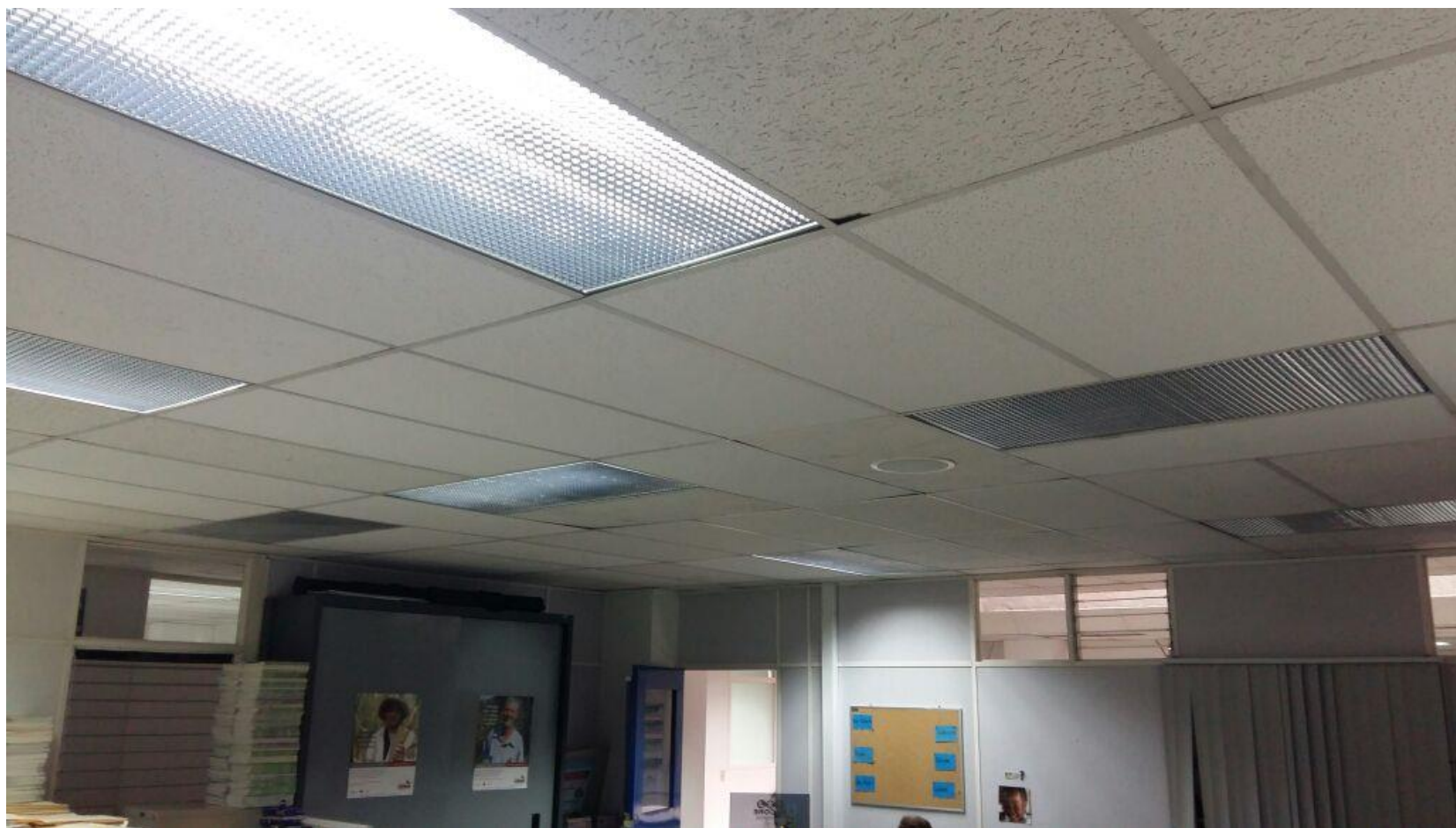
Red de iluminación eléctrica segmentada en oficinas
