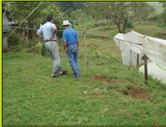
Foto 19. Instalación de tubería pvc para traslado de gas a lugar de consumo (Tomado de Fernando Martínez)
