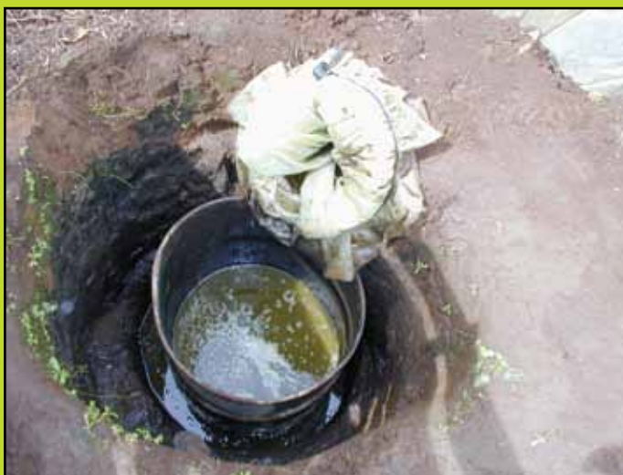
Foto 18. Instalación del receptor del efluente (Tomado de Fernando Martínez)
