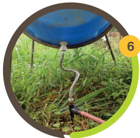
Figura 6: Sistema de abasto instalado.
