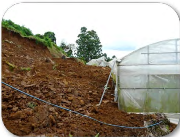
Figura 2. Invernadero afectado por un deslizamiento. Esta estructura se construyó al pie de un talud y no se hizo un estudio de estabilidad de taludes cuyo costo es de cientos de veces inferior al daño. Un estudio apropiado de suelos hubiera descartado este sitio.
