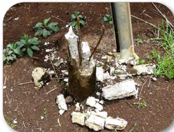
Figura 4. Cimiento mal diseñado para una carga lateral, se suma a esto un concreto de baja resistencia.
