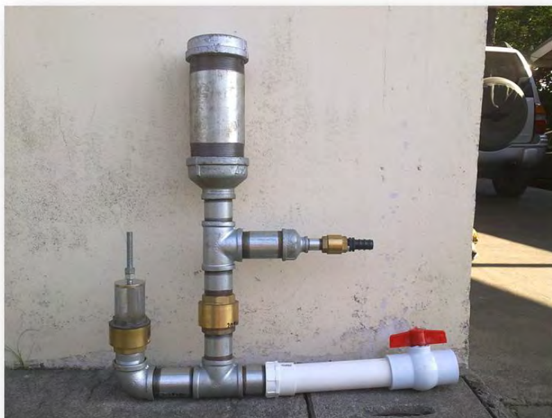
Figura 4. Un ariete construido con los materiales enlistados
