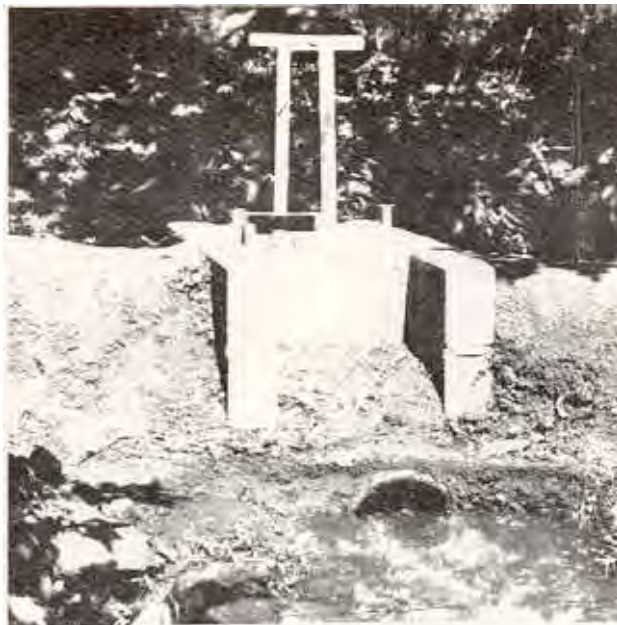
Obra de toma de orificio con carga constante a nivel de parcela
