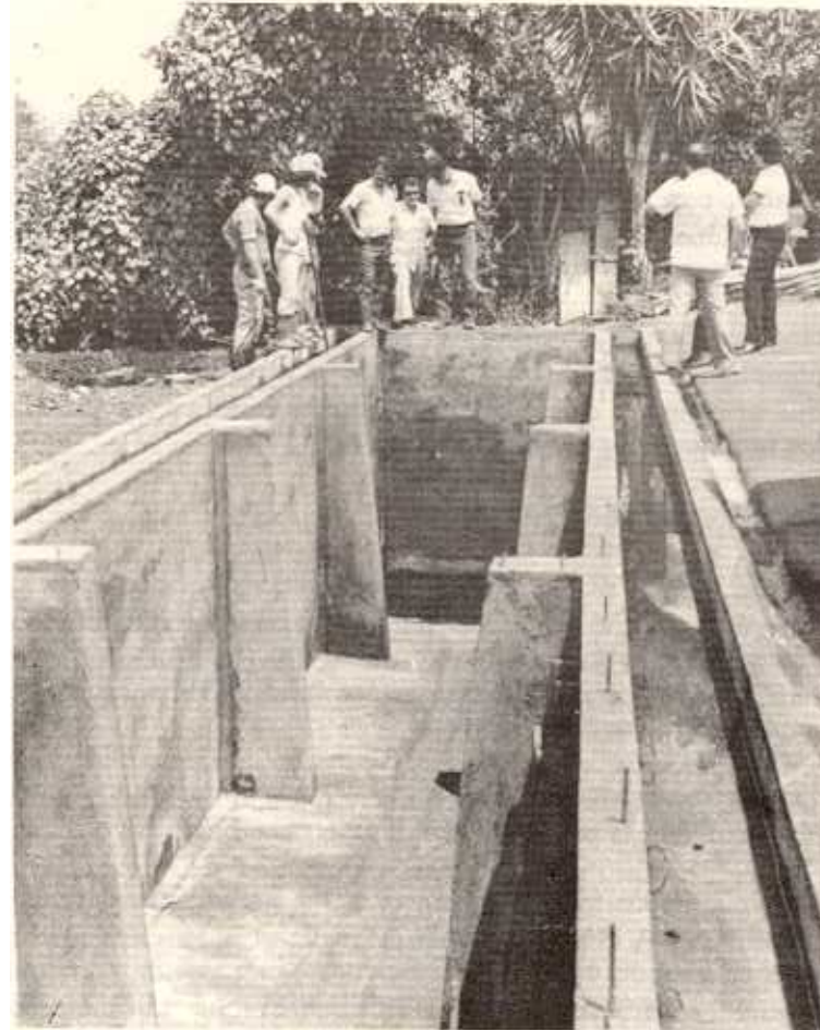
Biodigestores de 115 metros cúbicos, base de cemento y cúpula plástica en porqueriza
