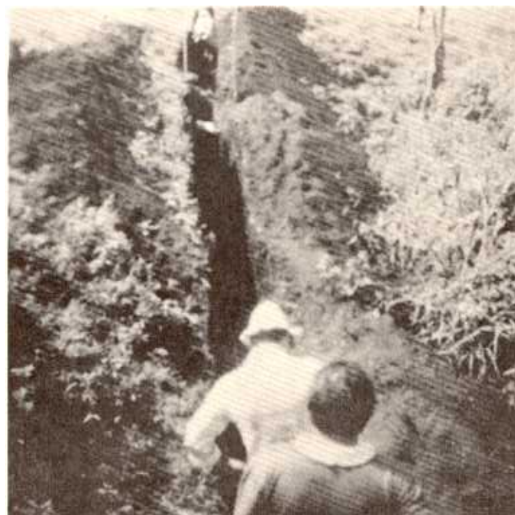
Construcción de zanja para instalación de cañería de conducción de agua para el beneficio de COOPETILA, Arenal
