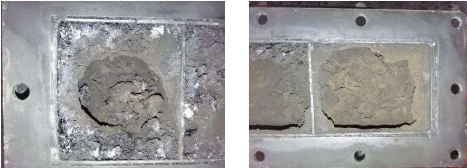
Figura 3.3.15. Detalle de la obstrucción del intercambiador de calor de la cámara de presecado.
