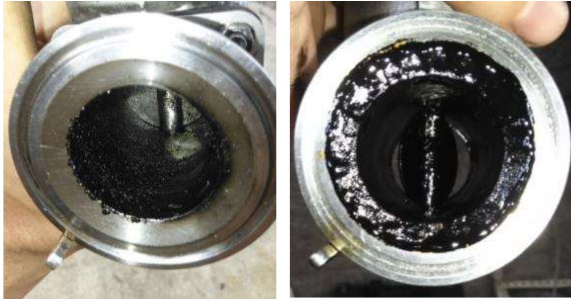
Figura 3.2.2. Comparación del ensuciamiento típico del gobernador al operar con chips de madera (izquierda) y pellets de broza (derecha).
